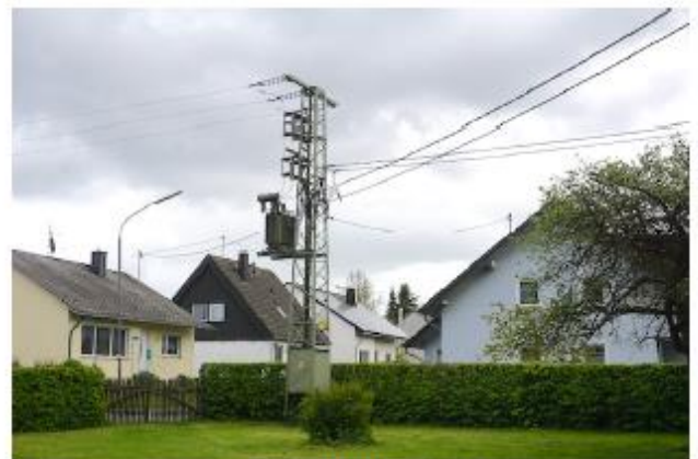
Trafostation auf der unbebauten östlichen Grundstücksteifläche
